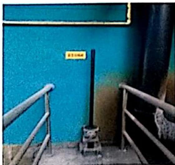
应急切换阀门标识完善
